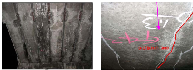
(a) ひび割れ発生状況 (b) ひび割れ部の拡大
