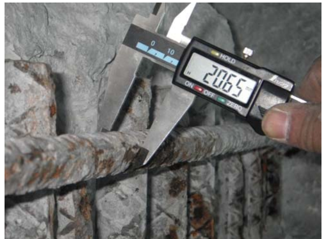
写真-3 橋脚梁部の鉄筋腐食状況
