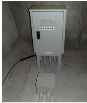
写真-5 P6橋脚に設置した子機
