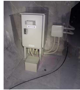
写真-6 A2橋台に設置した親機
